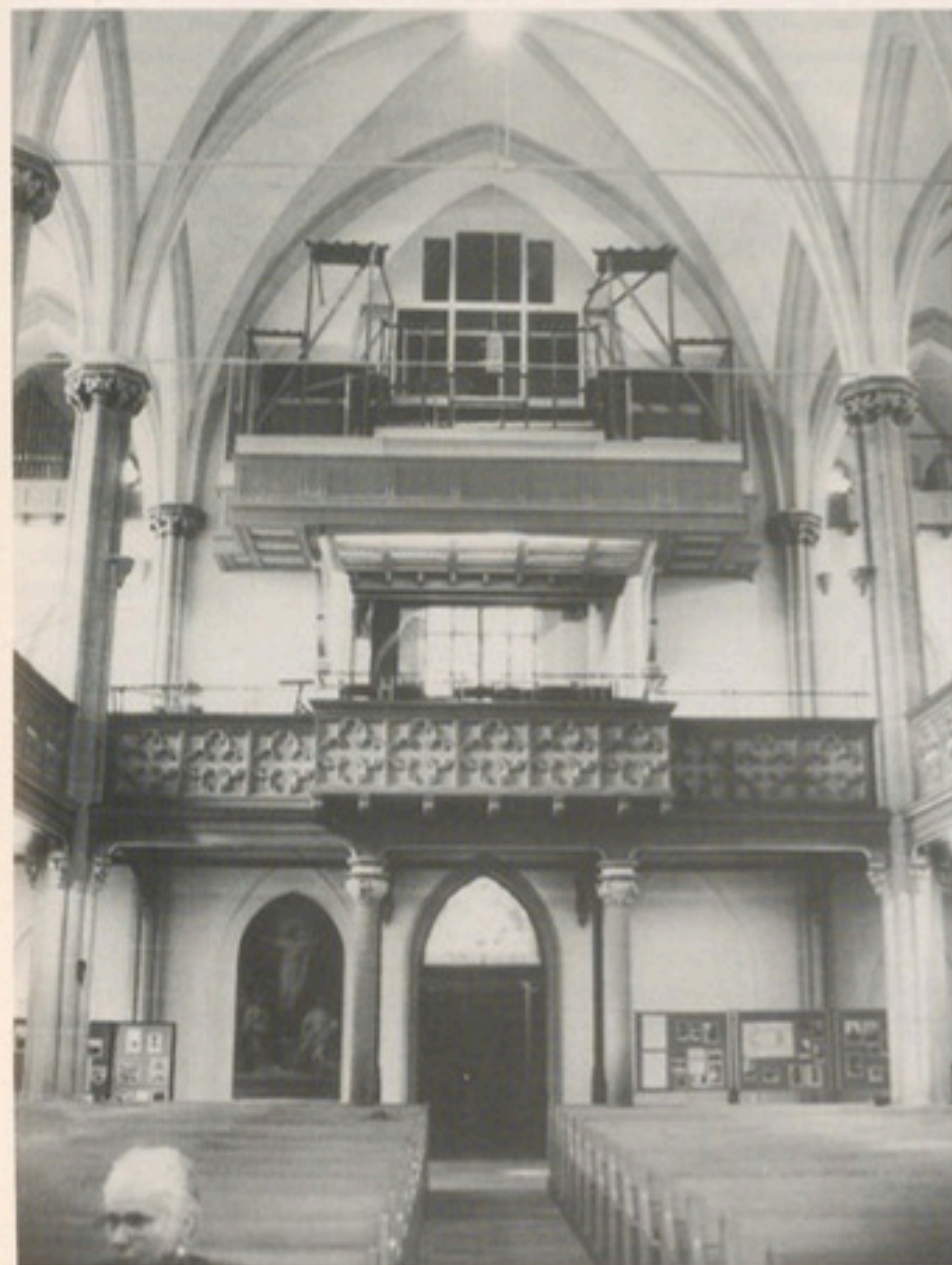
„Pflegerfall“ Martin-Luther-Kirche: Renovierungsarbeiten brachten massive Schäden in der Bausubstanz ans Licht. Jetzt setzt die Kirchengemeinde auf Spenden. Bild: Zimmermann
